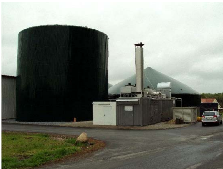
Fig. 3. Instalație de biogaz cu fermentare umedă “Big Dutchman” cu puterea electrică 500 kW
