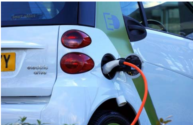
Fig. 3.53. Infrastructura pentru încărcarea acumulatorilor automobilelor electrice.
